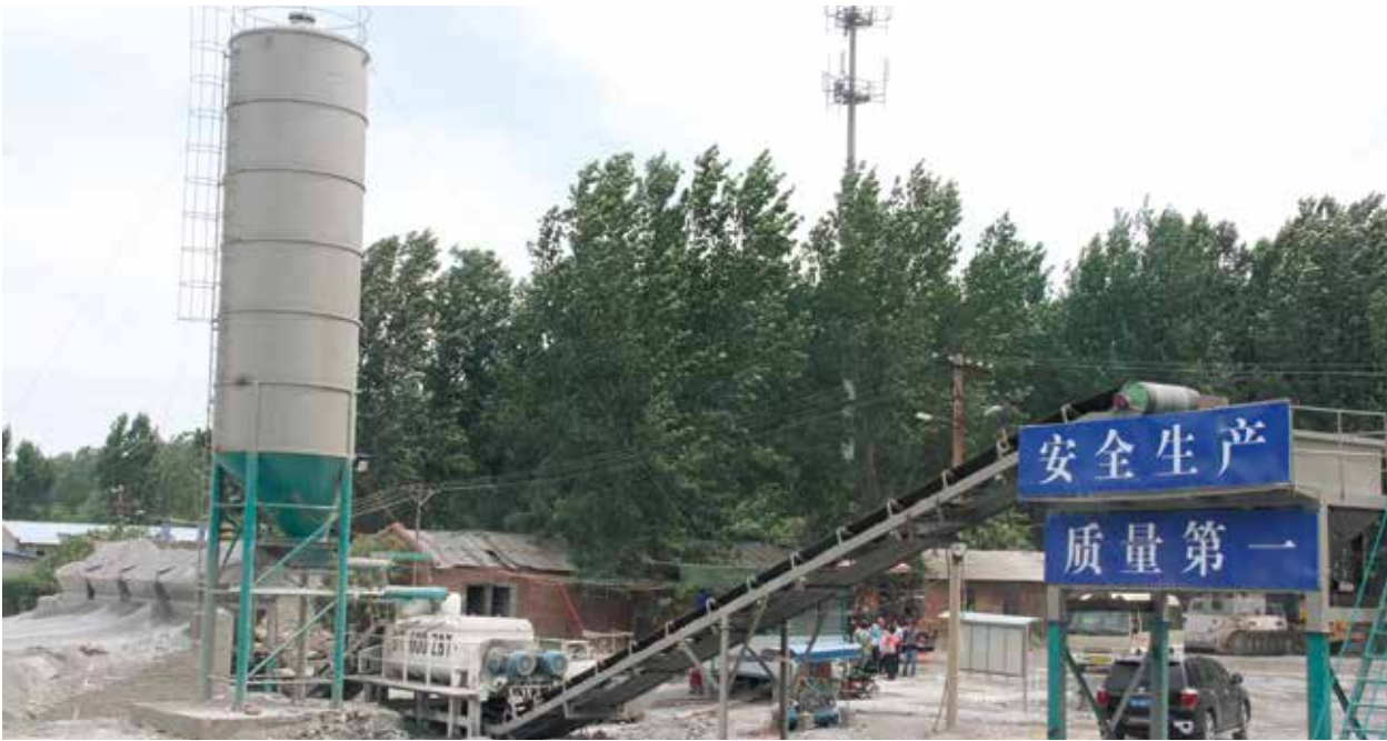
图 1 安装有 600t/h 连续式水泥稳定碎石振动搅拌装置的拌合站
